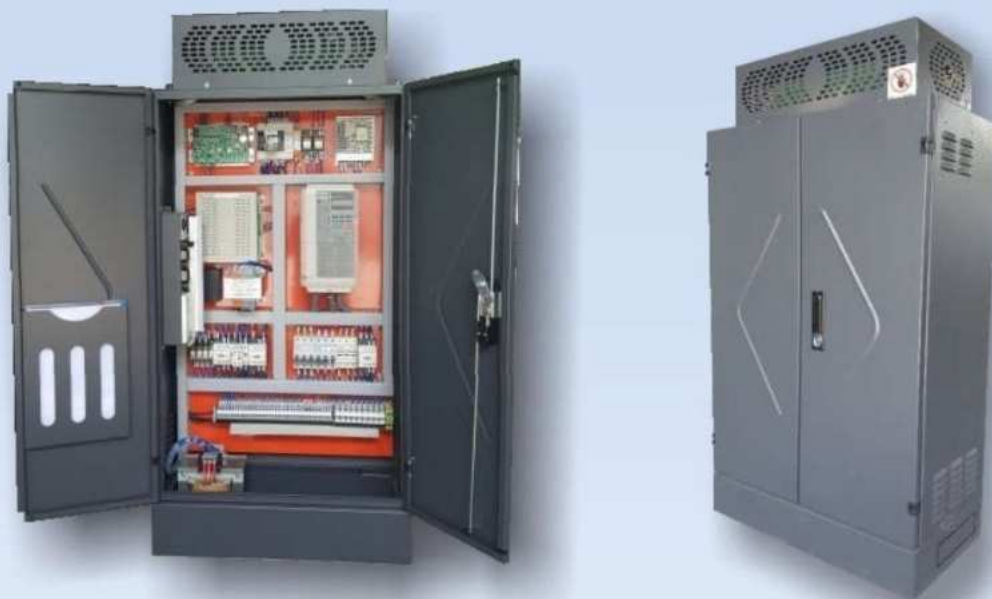
TỦ ĐIỆN PLC FX3G + VVVF YASKAWA (W600 X D300 X H1260)
